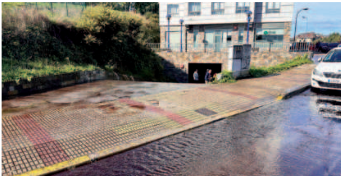
Rotura de una tubería en A Corveira.
