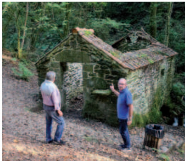
El alcalde, Manuel Vázquez Faraldo, comprobó junto al concejal de Obras, Agustín Sanz, el deterioro en las infraestructuras.
